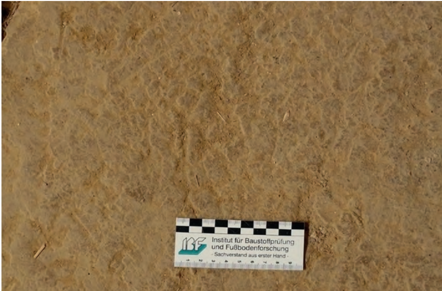
Lehmestrich nach längerer Gebrauchsdauer mit geschlossenen Rissen (Bild: Walter Böhl).
