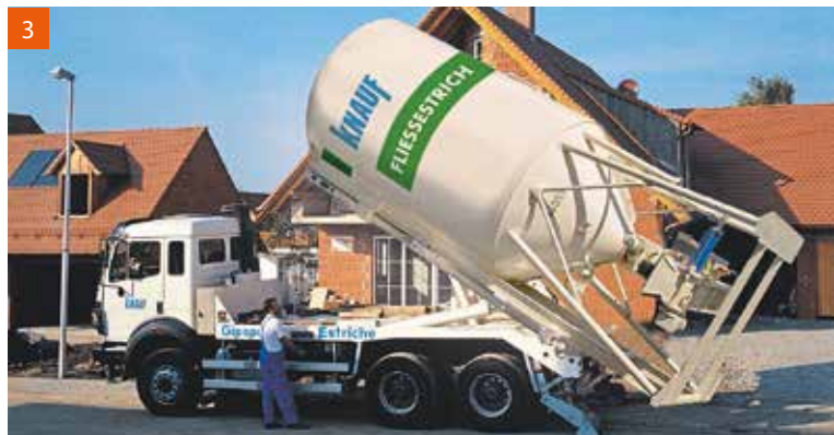
3 Trockenmörtel aus dem Silo oder aus Säcken. Man kann genauso wie bei Fertigmörtel vorgehen. Streng genommen ist der Mörtel mit Anlieferung an die Baustelle noch nicht fertig. Es muss ja noch Wasser dazu und es muss gemischt werden. Der Estrichleger muss eben darauf achten, dass er dies richtig macht und kann dann die Leistungserklärung des Lieferanten übernehmen, bei dessen Prüfungen die Wasserzugabe schon angenommen wurde. Foto: Knauf
