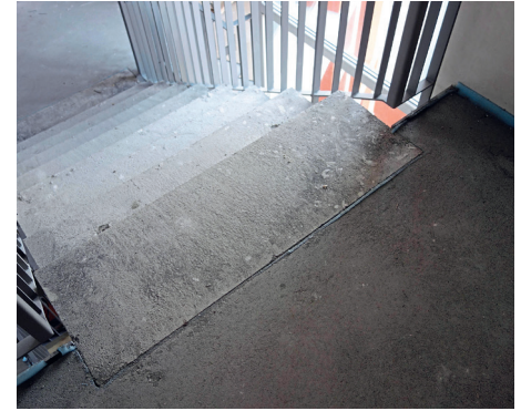
Bewegungsfuge zwischen Stahlbetontreppenlauf und Podest.
