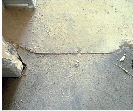
Nicht fachgerecht ausgebildete Bewegungsfuge zwischen Gussasphaltestrich und Anhydritestrich.
